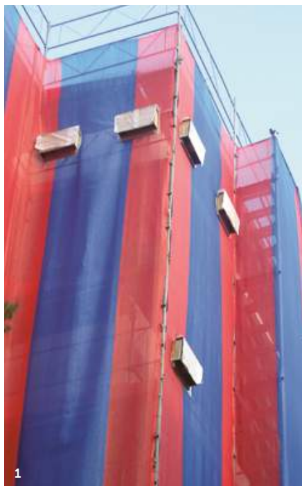
1 Damit die Alpensegler an diesem traditionellen Brutplatz in Baden während der lange andauernden Gebäudesanierung trotzdem brüten konnten, wurden Nistkästen am Gerüst aufgehängt.
