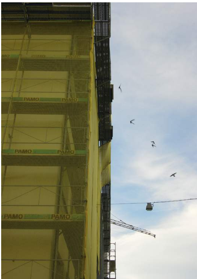
Baugerüst hindert Alpensegler am Anflug zu ihren Nistplätzen. Als Ersatz wurden Nistkästen am Gerüst montiert.
