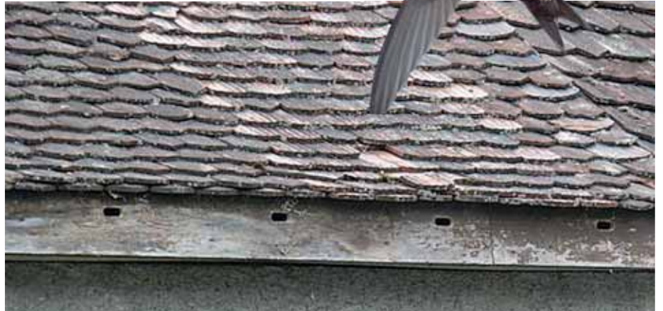
Mauersegler brauchen unsere Hilfe, weil oft nach Renovationen die natürlichen Brutplätze für die Vögel nicht mehr zugänglich sind.
