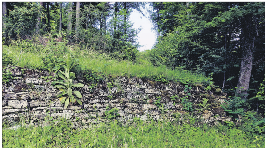
Der grosse Teil der Mauern ist gut erhalten, im Bild rechts ist sie jedoch sanierungsbedürftig Foto: Kai Huovinen
