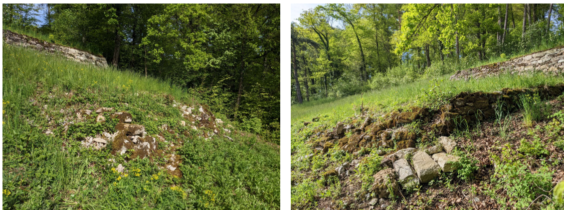
Abb. 8 & 9: Objekt 3: Der Eckbereich und die talseitigen Mauerteile sind eingefallen und müssen neu aufgebaut werden. Fotos: Philipp Schuppli
