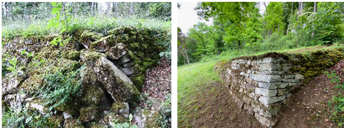
Abb. 6 & 7: Objekt 2. Die Mauerecke war eingestürzt. Im Rahmen einer Unterhaltmassnahme wurde die Mauerecke wieder aufgebaut. Links: Ausgangszustand, Foto: Kai Huovinen; Rechts: Nachher, Foto: Felix Riegger.
