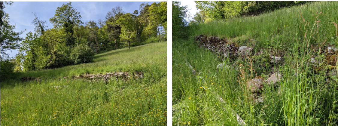
Abb. 4 & 5: Objekt 1. Die ganze Mauer ist infolge des Hangdrucks instabil geworden. Sie muss ab- und wieder aufgebaut werden. Rechts: Fotos: Philipp Schuppli.
